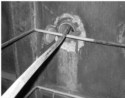
Рис. 1. Термозонд в паровом котле
