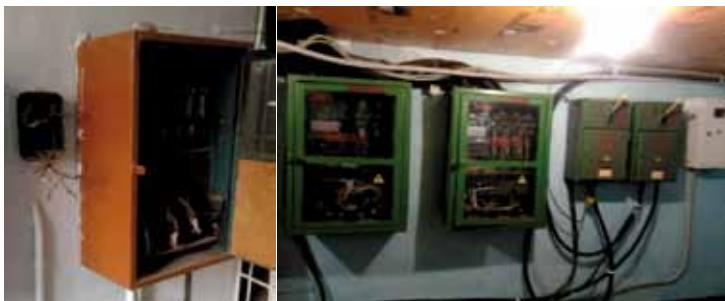
Рис. 4. Электрощитовые в некоторых школах после капитального ремонта
