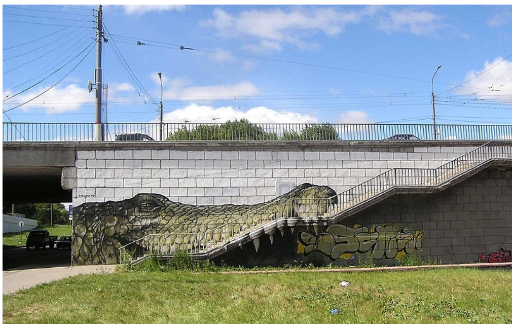
Рис. 1 Граффити на Канавинском мосту до его ремонта
