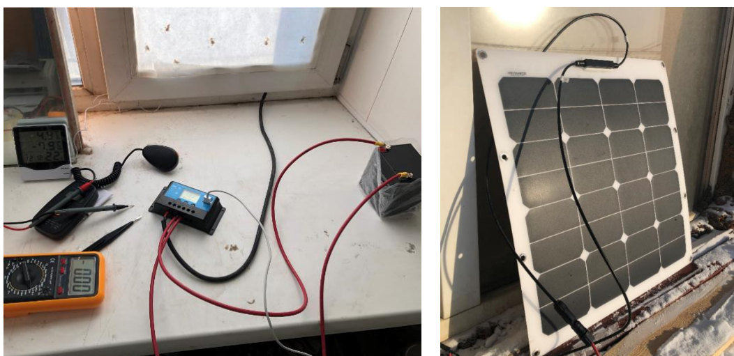
Рис. 1. Внешний вид солнечной электростанции
