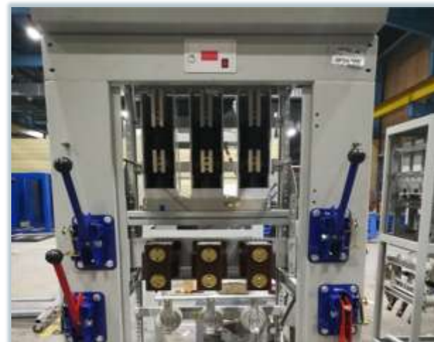
Камера сборная одностороннего обслуживания
