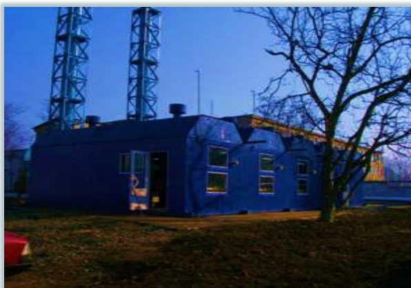
Обслуживание буровых установок посредством передвижных котельных установок ПКН-2М – 18 ед.
