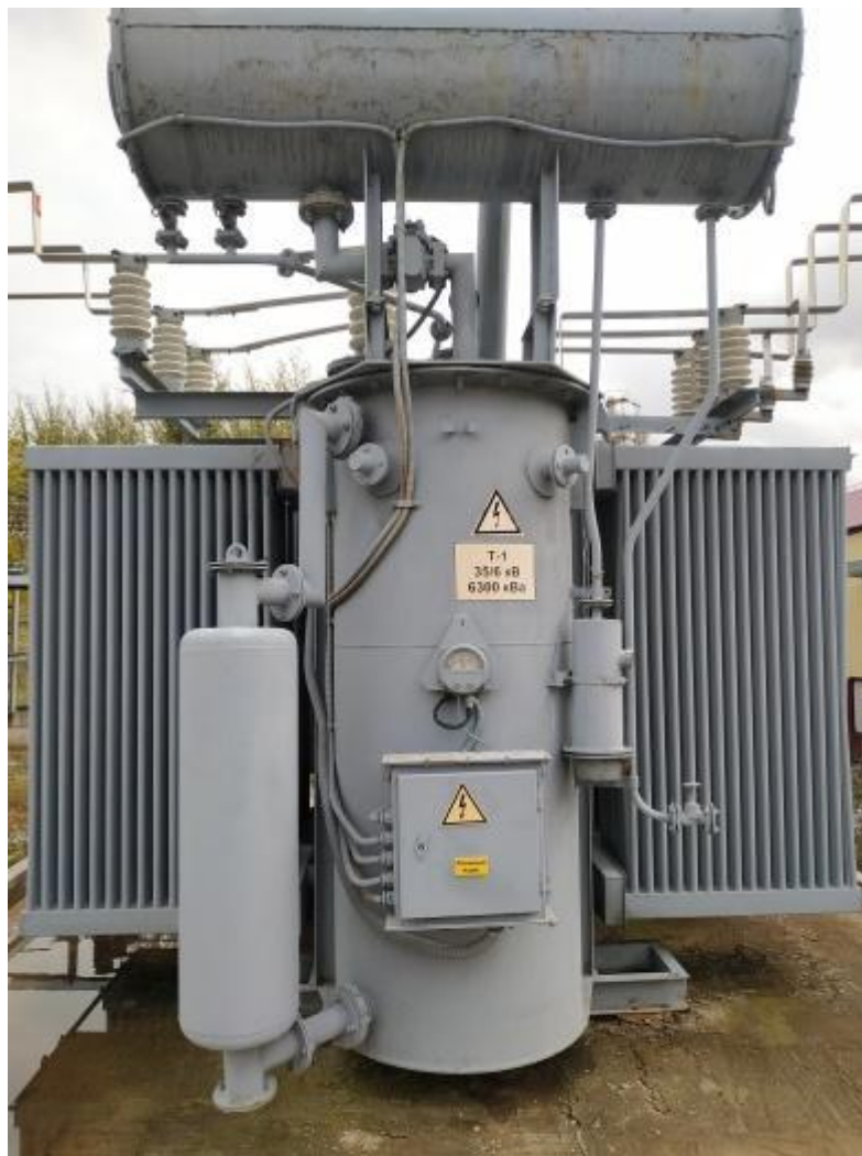
Рисунок 4.25. Силовой трансформатор ТМН 6300 35/6 кВ
