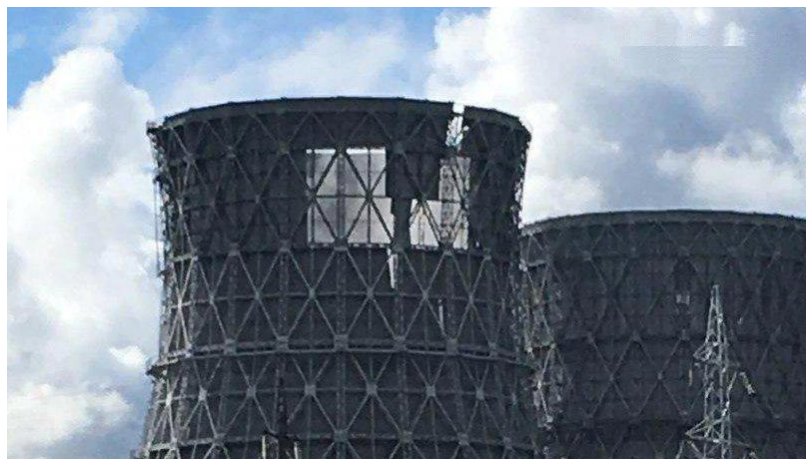
Рисунок 1.10 – Разрушение оболочки железобетонной башни градирни
