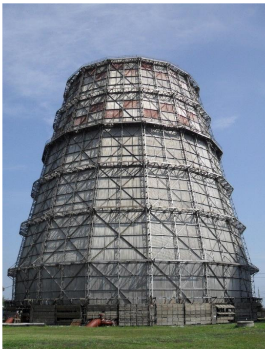
Рисунок 2.2 – Башенная градирня №3 Набережночелнинской ТЭЦ
