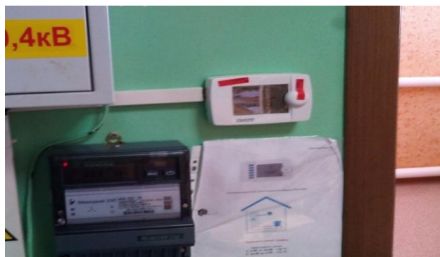
Рис. 6. Установленные термоконтроллеры в НГДУ «Азнакаевскнефть»
