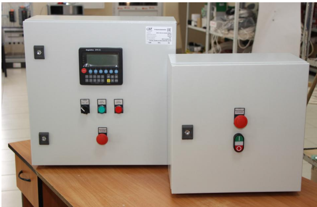
Рис. 1. Станция управления вентилятором градирни с использованием контроллера Segnetics и преобразователя частоты Danfoss производства компании «Стэк Мастер»
