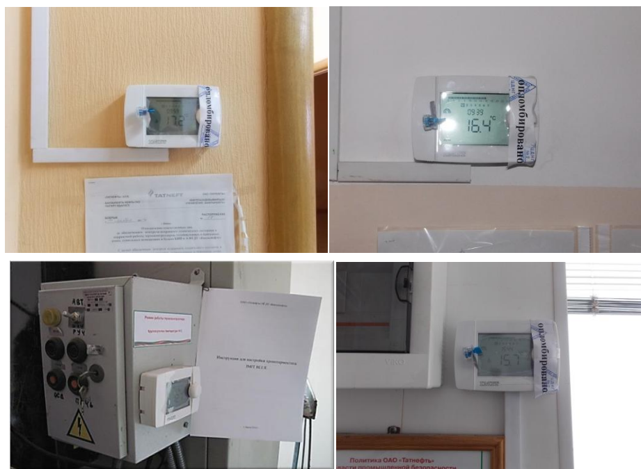
Рис. 4. Установленные термоконтроллеры в бригадных домиках ДНС НГДУ «Бавлынефть»
