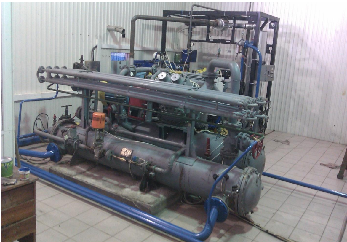
Рис. 2. Когенерационная установка с приводом от газопоршневого двигателя КАМАЗ в цехе Казанского филиала ООО «КамЭнергоРемонт»
