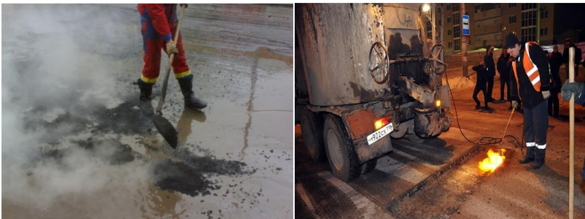
Рис. 3. Ремонт покрытия при плохих погодных условиях и ремонт покрытия при нагреве асфальтобетона
