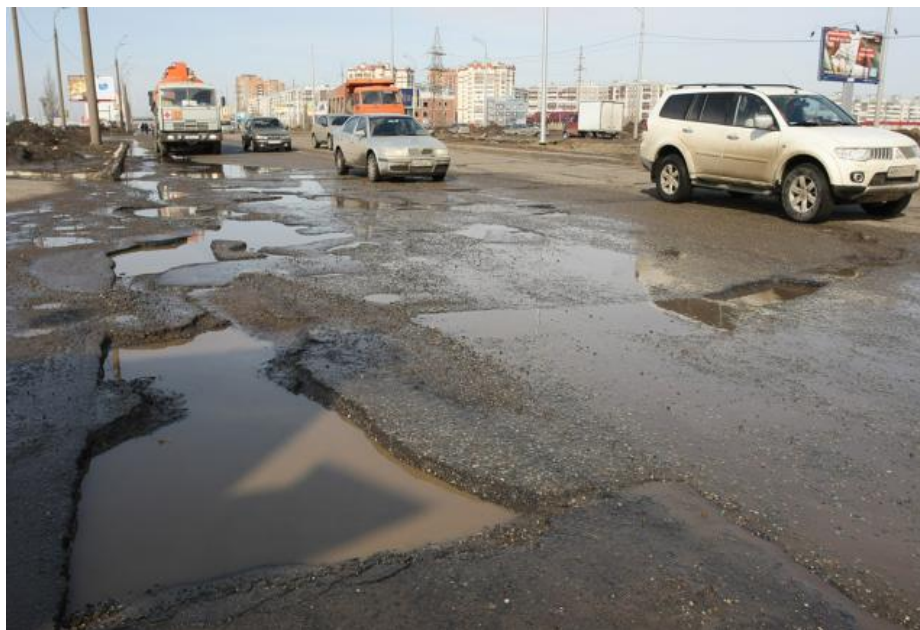
Рис. 1. Ямочные разрушения на дорогах
