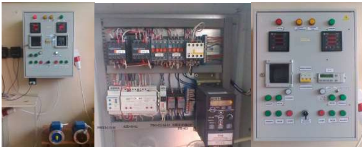
Рисунок 6 – Шкафы управления электроприводом в лаборатории кафедры
