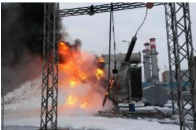
а) подстанция металлургического предприятия
