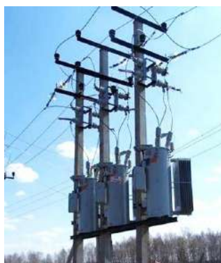
Рис.1. ПАРН на опоре ЛЭП
