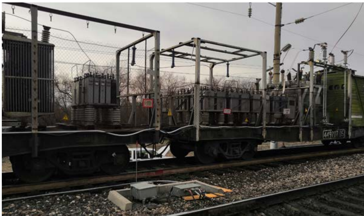
Рисунок 1. Фотография передвижной установки поперечной компенсации
