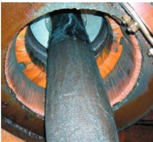
Рисунок 1 – Увлажнение нижней части ввода с RIP – изоляцией
