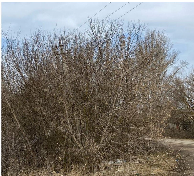
Рисунок 1 – Опора воздушной линии в предаварийном состоянии
