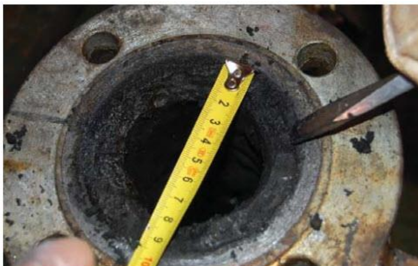
Рис 2. Отложение парафина и асфальтена в нефтепроводах на месторождении БТ
