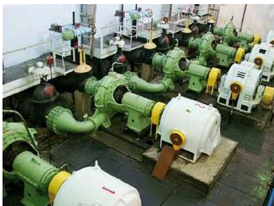
Рис. 1. Машинный зал канализационной насосной станции городского жилищно-коммунального хозяйства
