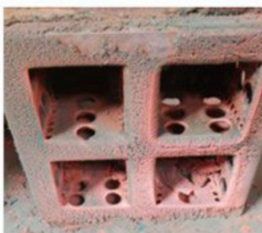
Мультивихревое сепарационное устройство в окрасочно-сушильной камере
