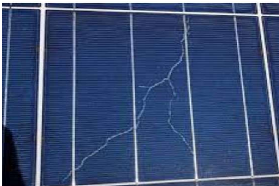
Рисунок 4. Микротрещины солнечного модуля
