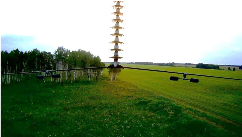
Рис. 2. Изображение провода и поддерживающей арматуры промежуточной опоры ЛЭП 220 кВ
