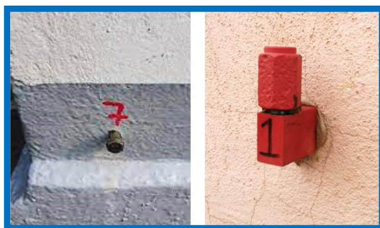
Рисунок 3 – осадочная марка № 7 в виде штыря, забитого в стену; б – осадочная марка № 1 с защитной крышкой, установленная на кирпичную стену здания с помощью профессионального клея Hilti [3]
