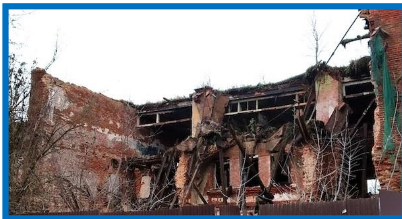
Рисунок 8 – Обрушение парадного фасада Гостиного двора в городе Кимры Тверской области [8]
