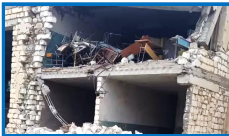
Рисунок 7 – Обрушение часть здания средней школы в селе Мехдили Бардинского района Азербайджана [7]
