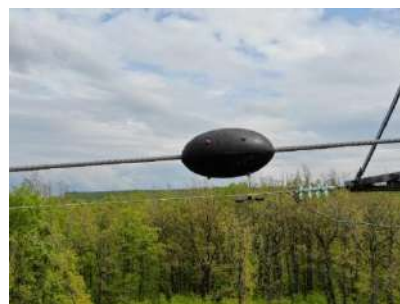
Рис. 2. Датчик СМГ установленный на провод ВЛ
