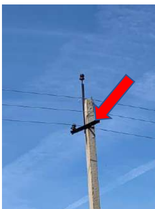
Рис. 2. ОЗ ВЛ - 10 кВ через стойку при обрыве вязки фазного провода Fig. 2. OZ VL - 10 kV through the strut when the knitting phase wire is broken
