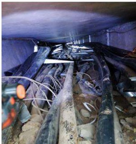
Рис. 1. Кабельный канал, проходящий от ТП до потребителей 0,4 кВ Fig. 1. Cable channel from TP to consumers 0.4 kV
