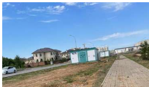
Рис. 3 - Фото улицы с расположением ТП 10/0,4 кВ Fig. 3 - Street photo with 10/0.4 kV TP location
