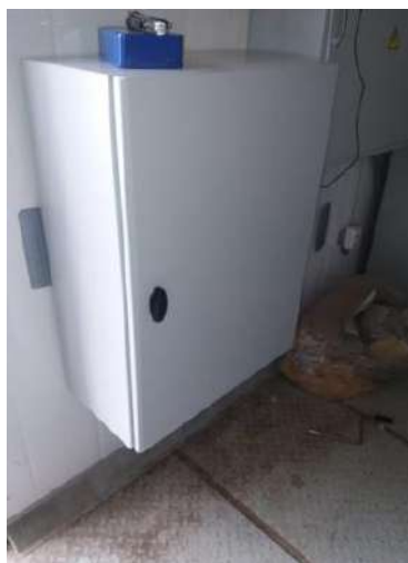
Рис. 5. Универсальный настенный шкаф с блоком обработки размещенный внутри помещения РП 10 кВ
