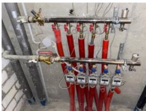
Рис. 3. Распределительный коллектор горизонтальной лучевой системы отопления, установленный в техническом помещении этажа многоквартирного жилого дома
