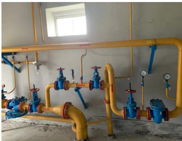
Рис. 1. Внутреннее устройство пункта редуцирования газа №17 в городе Белгород, как вид газораспределительной системы
