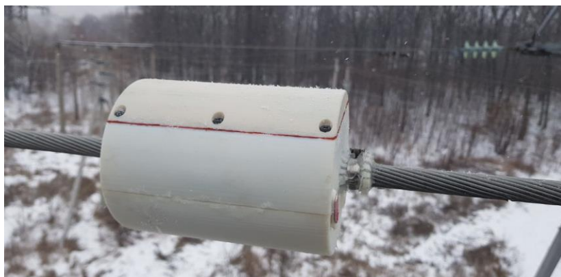
Рис. 2. Устройство контроля системы мониторинга состояния ЛЭП, установленное на проводе
