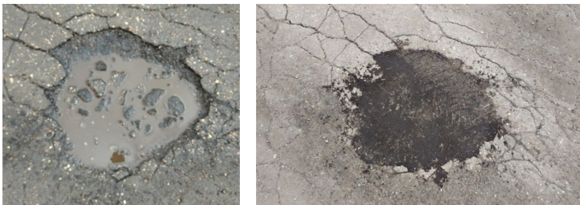
Рисунок 1. Выбоины до и после ремонта
