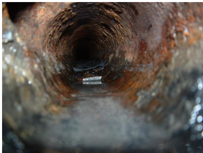
Рис. 1. Коррозия внутренней поверхности исследуемого трубопровода
