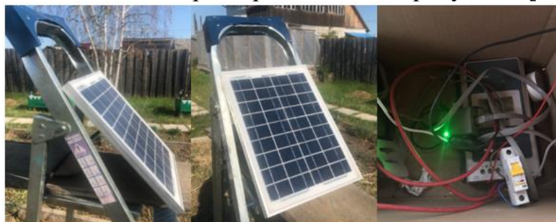
Рис. 2. Внешний фотоэлектрической установки
