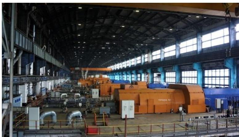
Рис. 3. Турбинный цех ГРЭС 1
