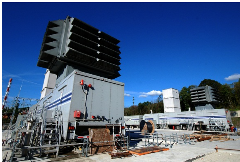
Рисунок. 1 – Мобильная газотурбинная электрическая станция
