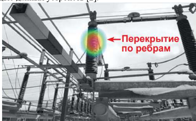
Рисунок 1 – Перекрытие по ребрам изоляторов на ОПУ
