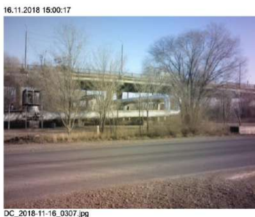
Тепловизионная съемка участка трубопровода с изоляцией и без
