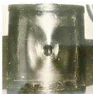
Рис. 5. Панель Л62 с отверстием после потери устойчивости
