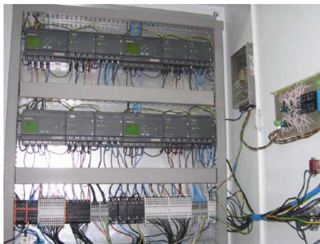
Рис .4. Шкаф системы автоматизированного контроля баллонов
