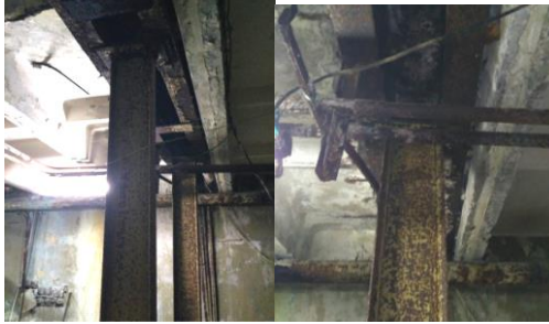
Рис. 1. Поврежденные коррозией колонны
