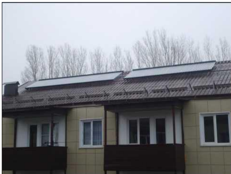
Рисунок 2 – Солнечные коллекторы на крыше многоквартирного дома в поселке Иноземцево (Ставропольский край)
