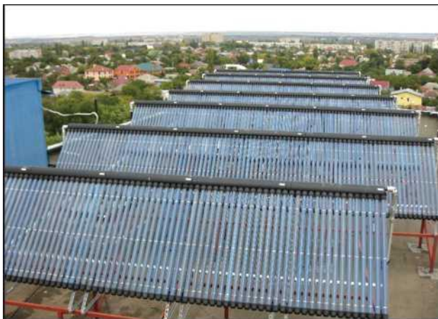
Рисунок 1 – Солнечные коллекторы (42 вакуумных коллектора KAIROS VT) на крыше поликлиники в городе Минеральные воды (Ставропольский край)
