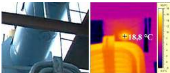
Рис. 3 – Локальный перегрев опорного изолятора токопровода
