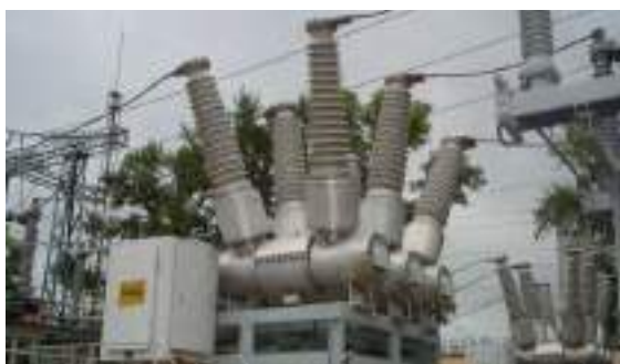
Рис. 1 – Фото оригинального выключателя ВЭБ-110 (УЭТМ), установленного на ОРУ-110 кВ подстанции
