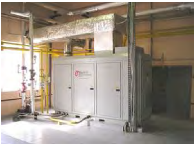
Рис. 2 – Внешний вид микротурбинной установки ТА-100RCHP
