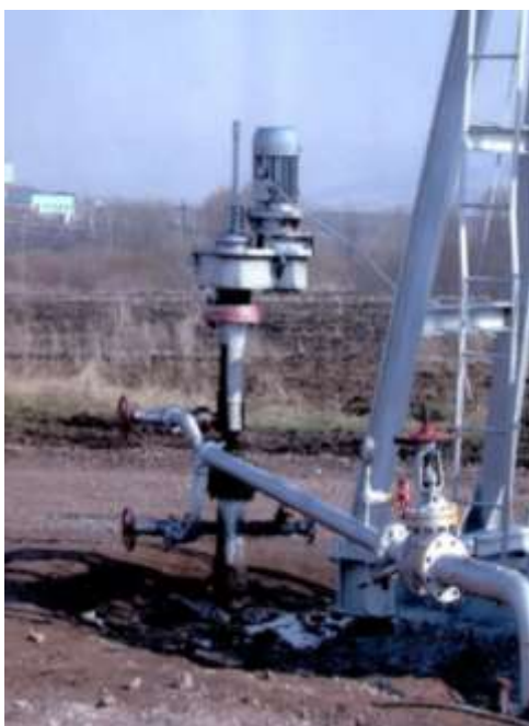
Рисунок 1 - Винтовая насосная установка с поверхностным приводом
