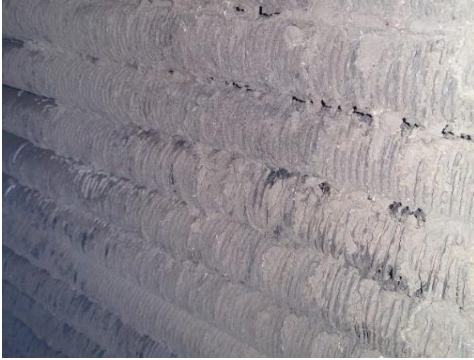
Рис. 1. Фото оребренных труб теплообменника со слоем отложений
