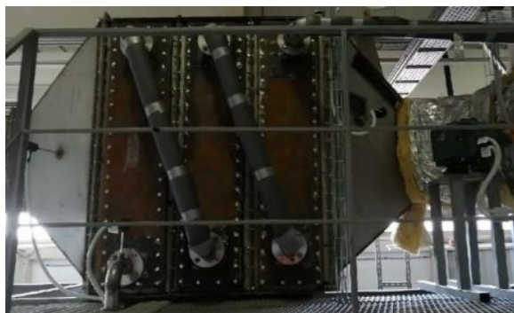
Рис. 3. Теплообменный аппарат, установленный на промышленном объекте компанией ООО «Филиал ВПМ»
