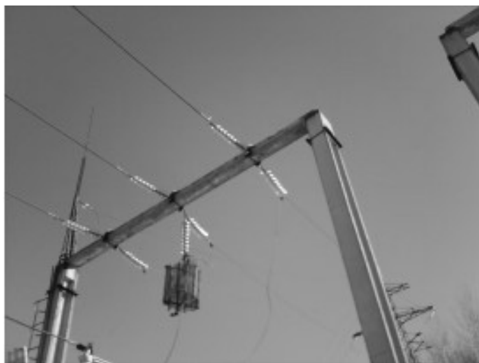
Рис.2.7. Общий вид гирлянд изоляторов, обследованных с помощью акустического и тепловизионного методов
