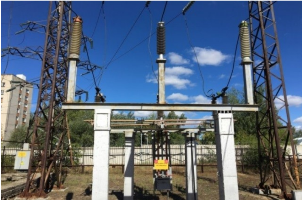
Рис. 5.12. Общий вид подстанции «Западная» Казанских электрических сетей ОАО «Сетевая компания»
