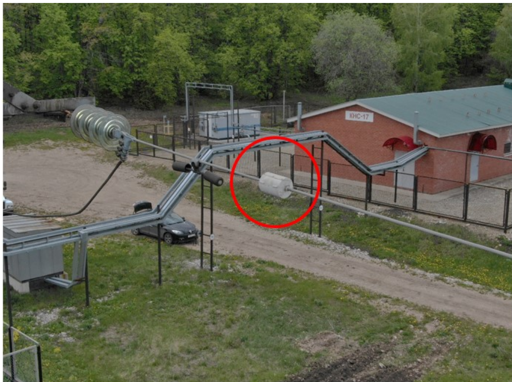
Рис. 3.9. Модернизированная Система, установленная на ЛЭП 35 кВ в ПАО «Татнефть»
